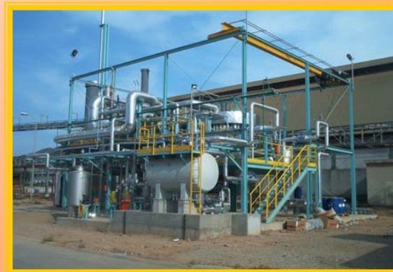
Reformador de etanol
